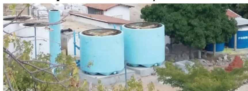
A manutenção é de caráter preventivo e corretivo e garantirá o funcionamento normal da ETA
